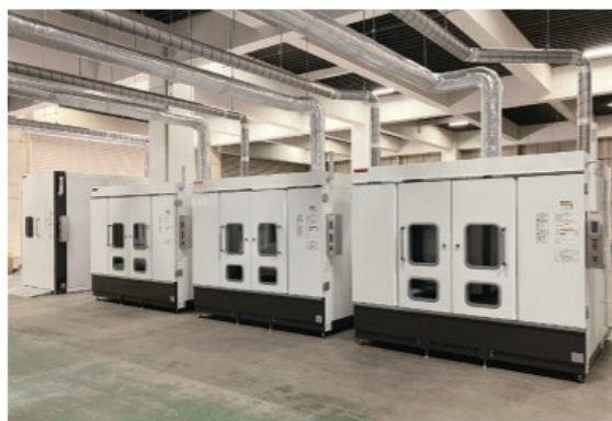
高速マットレス乾燥機も揃え、 処理能力が飛躍的に向上
